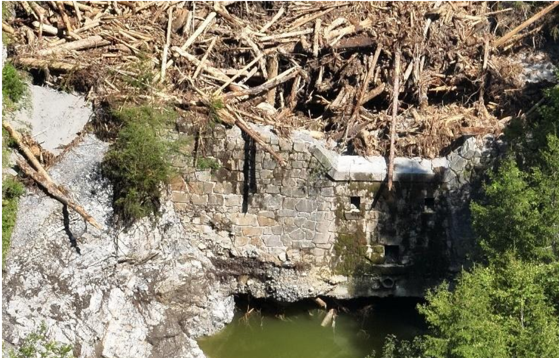
Abbildung 99: Unterspülung Sperre, Baujahr 1963, hm 73,5 (19.07.2024), Quelle: die.wildbach
