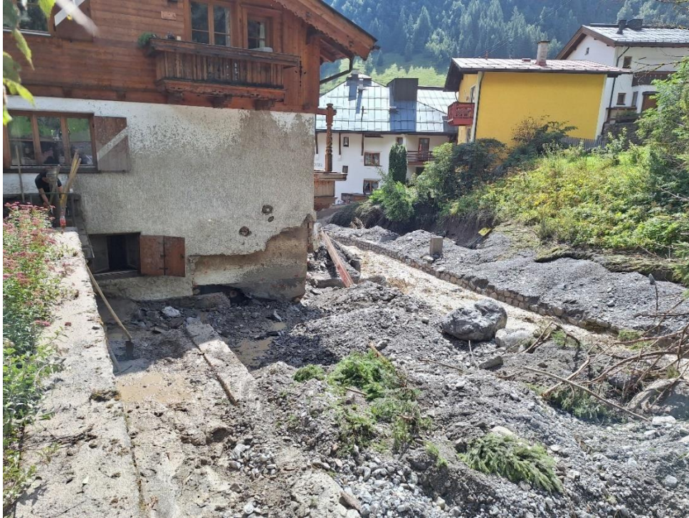
Abbildung 119: hm 2,00: Zerstörte Fassade (Blick in die Fließrichtung); Quelle: die.wildbach
