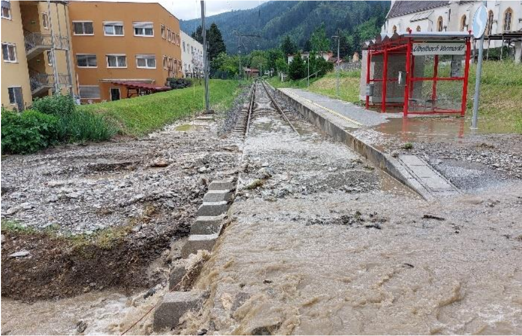
Abbildung 35: Unterspülter Gleiskörper, hm 0,0 (09.06.2024) © WLV.
