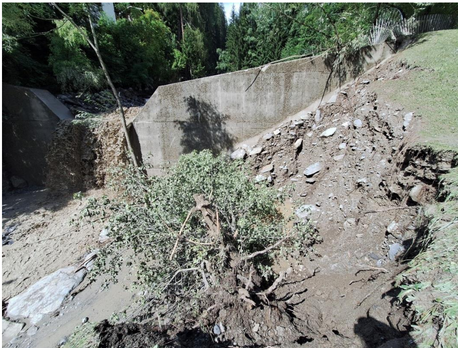
Abbildung 120: hm 3,30: Sperrenflügel luftseitig durch starke Erosionen teilweise freigelegt (Blick gegen die Fließrichtung); Quelle: die.wildbach
