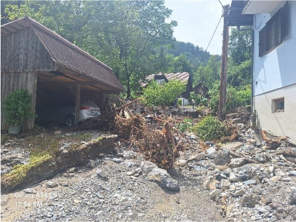
Abbildung 48: Ablagerungen von Murgang bachaufwärts, hm 0,6 (09.06.2024) © WLV.
