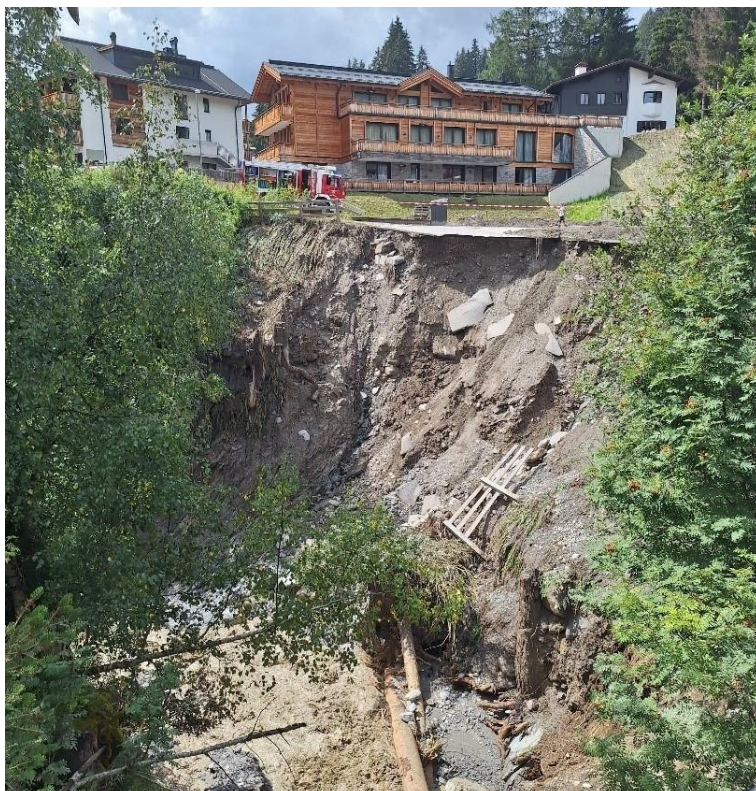
Abbildung 122: hm 8,50: Zerstörte Straße durch Hangerosionen; Quelle: die.wildbach
