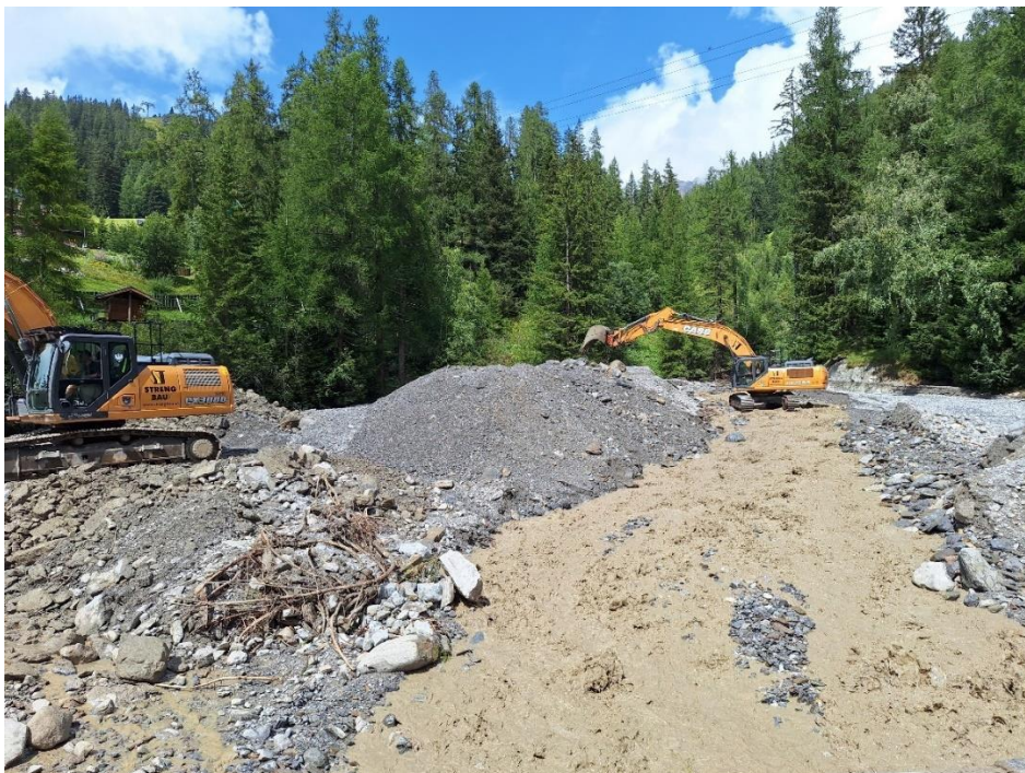
Abbildung 126: hm 9,90-11,00: Becken 2 „Steissbach“ ca. 35.000m 3 Feststoffablagerungen; Quelle: die.wildbach
