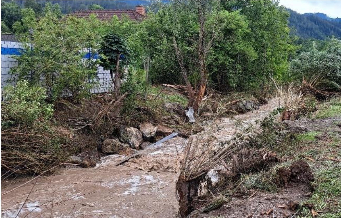
Abbildung 92: Bachausbruch unter Brücke, hm 31,0 (17.07.2024), Quelle: die.wildbach
