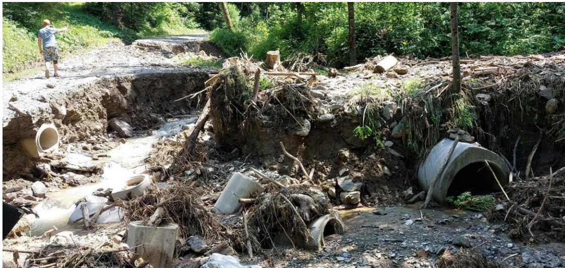
Abbildung 44: Seitenerosion auf Hofzufahrt, hm 9,2 (09.06.2024) © WL.V.
