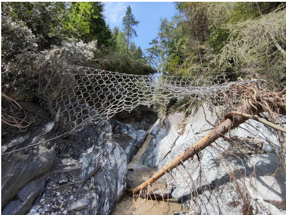
Abbildung 124: hm 11,60: teilweise zerstörte Netzsperr; Quelle: die.wildbach
