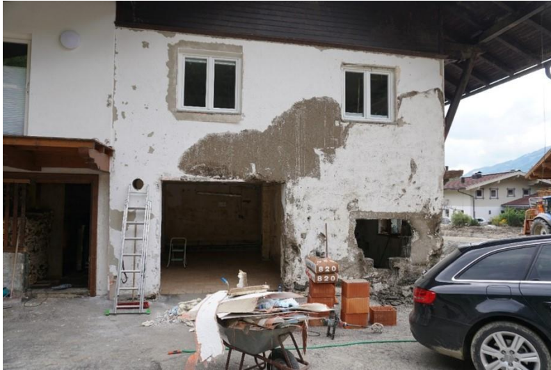
Abbildung 38: Die Wohnobjekte im Bereich des Grabenausganges wurden teils stark beschädigt.
