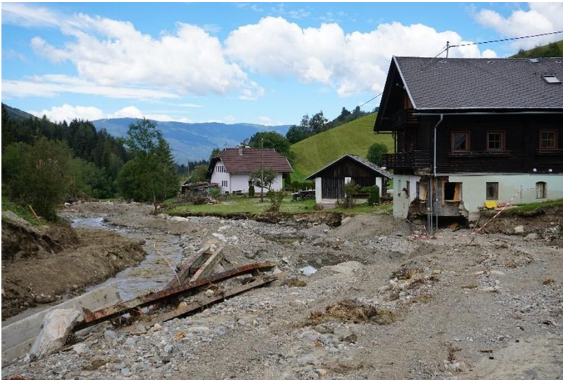
Abbildung 79: hm 68,5: Sohl- und Seitenerosion im Bereich nach der Einmündung des Hinterwinklbachs. Bachbettbreite ca. 20 (Blickrichtung bachabwärts)
