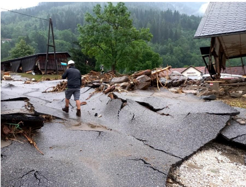
Abbildung 66: Zerstörte Pöllingerstraße nach Bachausbruch durch Brückenverklauung
