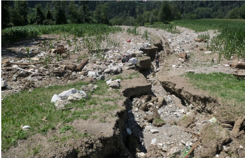
Abbildung 76: hm 3,00; Durch Verklausung der Brücke kam es zu einem rechtsufrigen Ausbruch des Schlossbauerbaches und nachfolgendem Abfluss über die angrenzende landwirtschaftliche Ackerfläche. Die entstandene Tiefenerosion erreicht dabei Tiefen von > 1,5 m.
