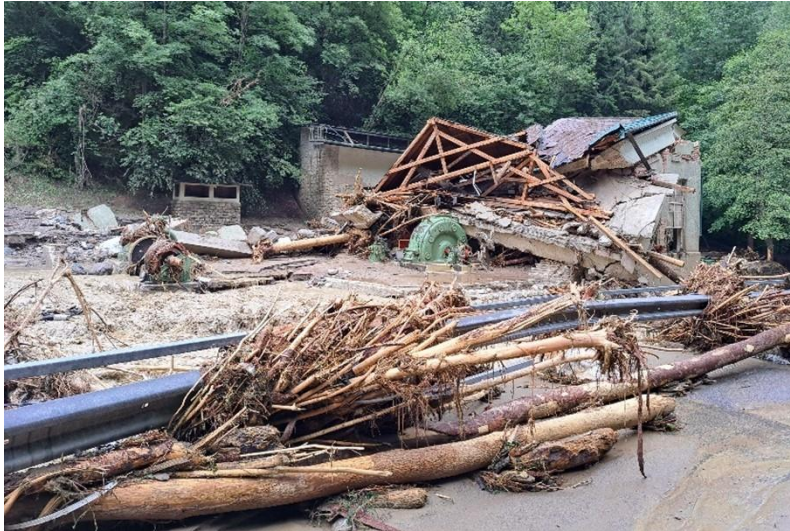
Abbildung 81: Durch Bachausbruch zerstörtes Krafthaus (Blickrichtung bachabwärts)
