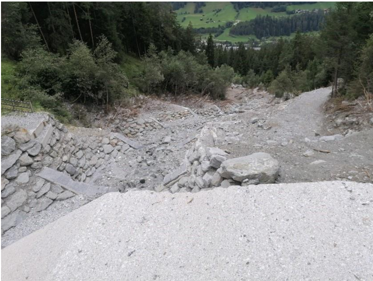
Abbildung 22: Sperrstaffelung bei hm 10,80 und zerstörte Forstwegbrücke nach Ereignis in blick Richtung bachabwärts
