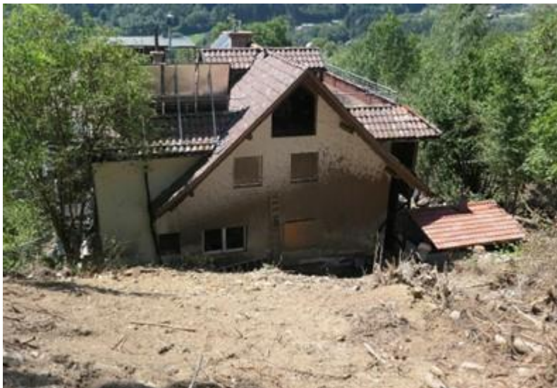
Abbildung 75: hm 5,10: Vermurung des Wohngebäudes auf der Grundparzelle 17/4 (KG Winklern)
