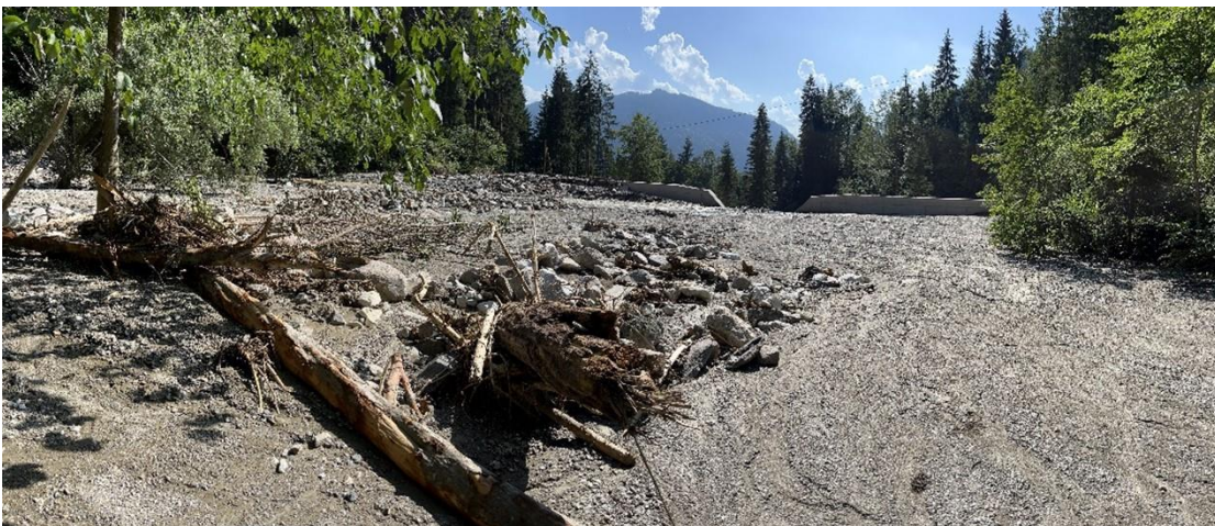
Abbildung 68: Gänzlich verfüllte Geschieberückhaltesperre in hm 17,2
