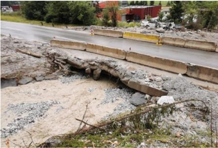
Abbildung 26: Beschädigte und überbordete Landesstraßenbrücke nach dem Ereignis
