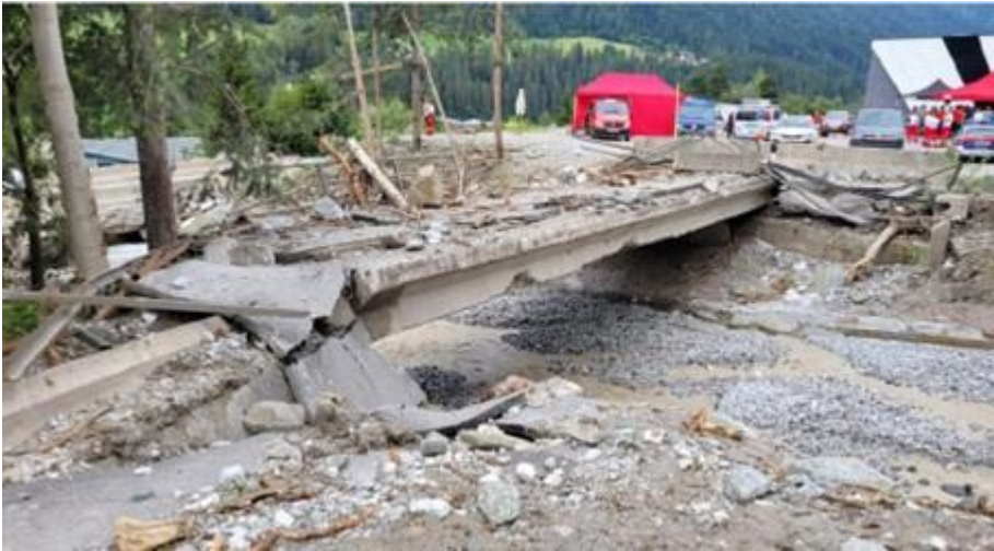
Abbildung 25: Zerstörte und überbordete Gemeindestraßenbrücke nach Ereignis
