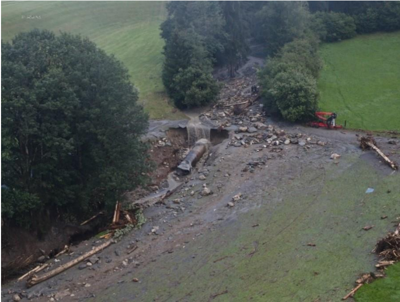
Abbildung 36: Durch die Verklammerung des Durchlasses ist es zu einem erheblichen Gerinneausbruch auf die angrenzenden Grünflächen gekommen. Der Straßendurchlass wurde komplett zerstört.
