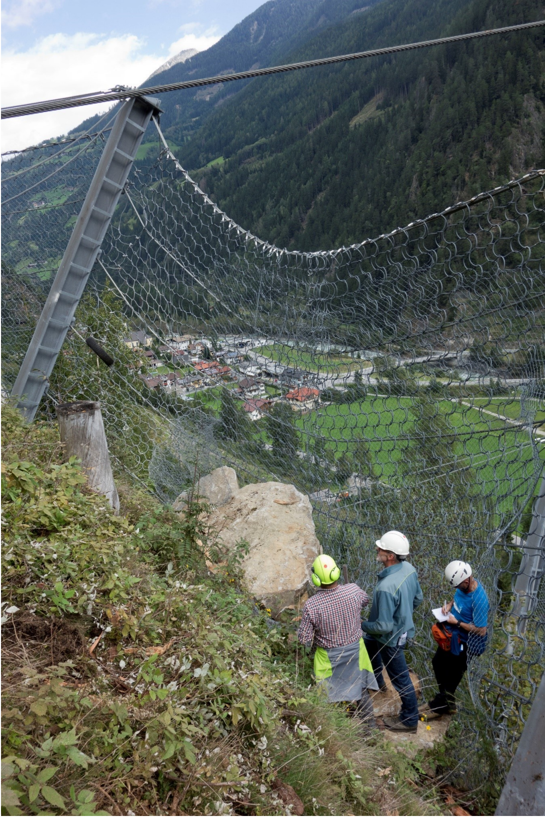
Abbildung 22: Nachkontrolle von Steinschlagschäden in technischen Schutzbauwerken durch Mitarbeiter der Wildbach- und Lawinenverbauung
