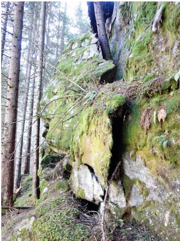
Abbildung 5: Auflockerung von Fels durch Wurzeldruck
