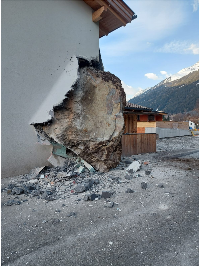
Abbildung 9: Massiver Gebäudeschaden durch einen acht Kubikmeter großen Sturzblock
