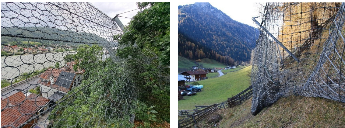
Abbildung 17: Technischer Steinschlagschutz (Schutznetze) konzipiert und gebaut durch die WLV
