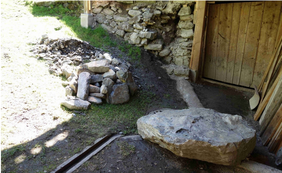
Abbildung 3: Einschlagspuren in einem Trockenmauerwerk (verursachender Sturzblock im Bildvordergrund)
