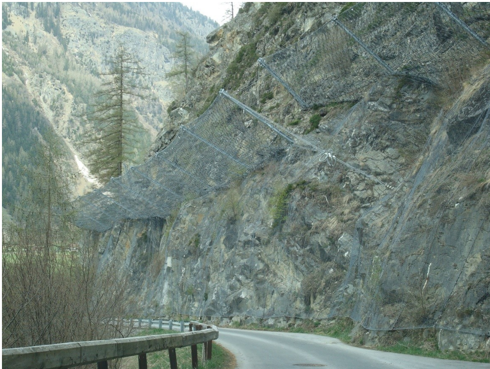
Abbildung 19: Steinschlagschutznetz (Galerienetz) als Schutz für Straßen und Infrastruktur
