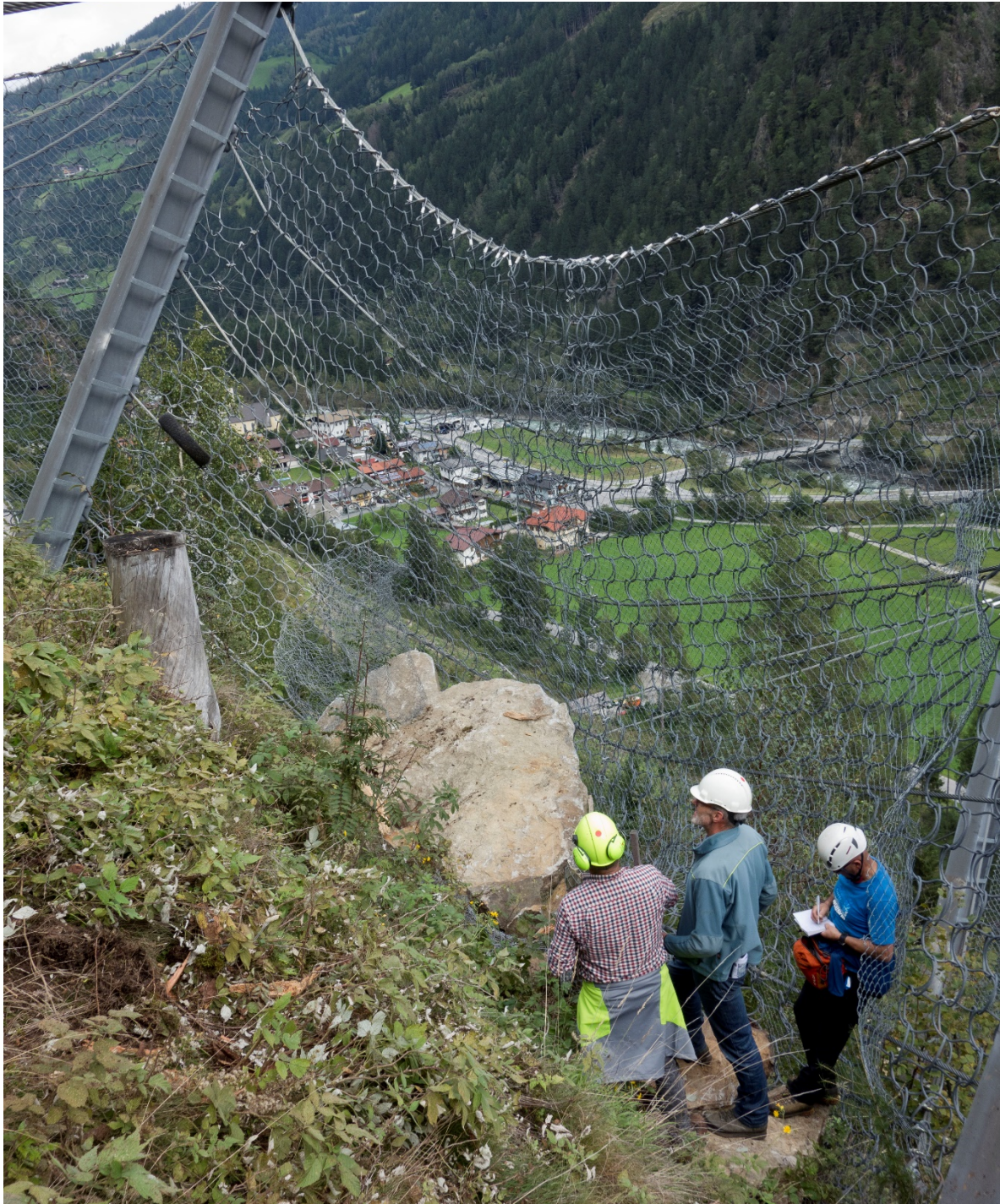
Abbildung 16: Nachkontrolle von Steinschlagschäden in technischen Schutzbauwerken durch Mitarbeiter der Wildbach- und Lawinenverbauung
